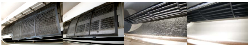
フィルター部分(洗浄前) ⇒ フィルター部分(洗浄後) 噴出し部分(洗浄前) ⇒ 噴出し部分(洗浄後)
